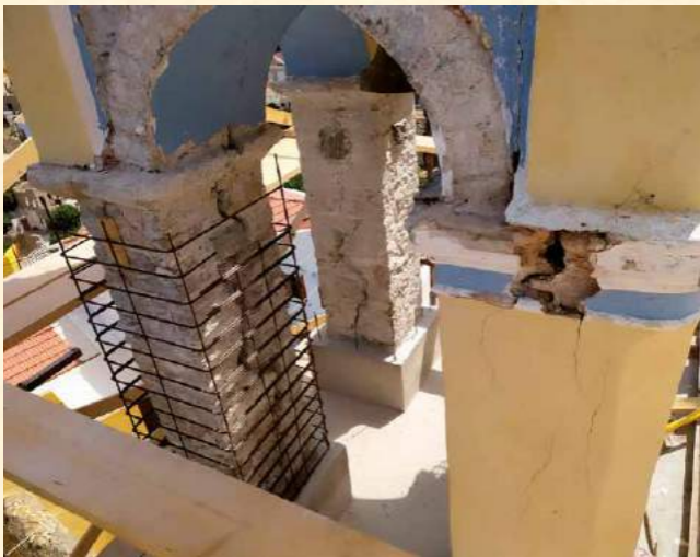
Ἄποψη τοῦ Κωδωνοστασίου τοῦ Ἱ. Ναοῦ Ἁγ. Παντελεήμονος Σύμης, κατά τίς ἀναστηλωτικές ἐργασίες.
